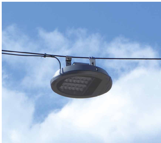
Seilleuchte mit 48 Watt LED-Modul (bisher 500 Watt)
